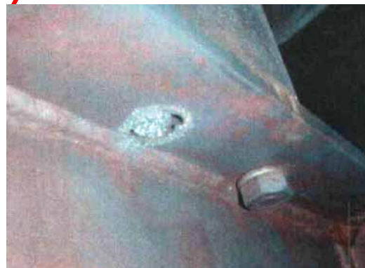
ボルト折損部の様子
