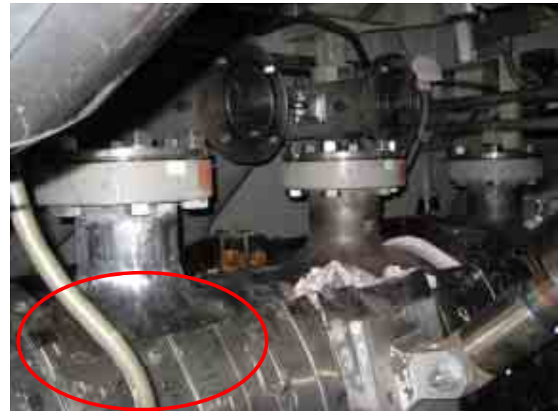
主蒸気系配管外観
