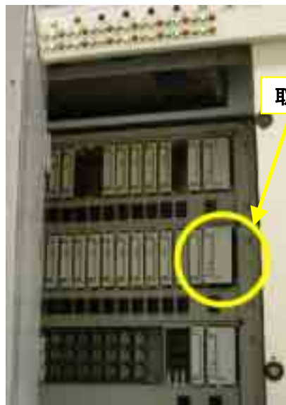
平均出力領域モニタ制御盤
