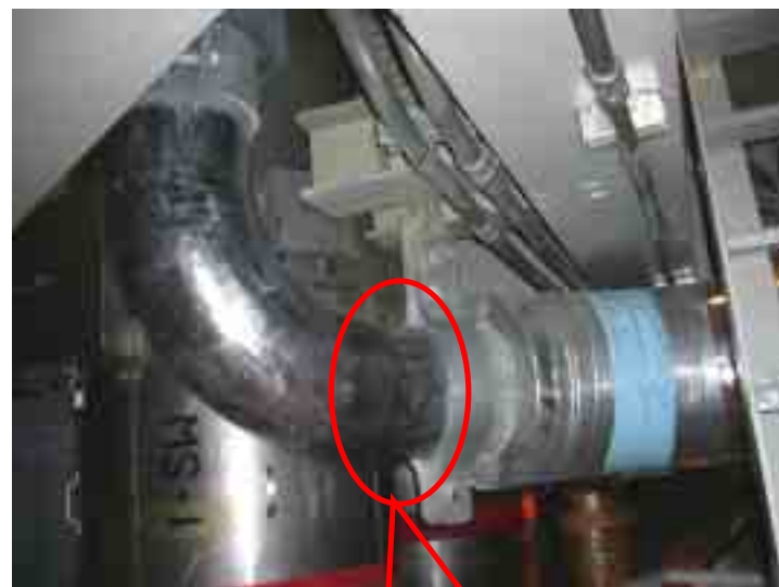
残留熱除去系配管外観
