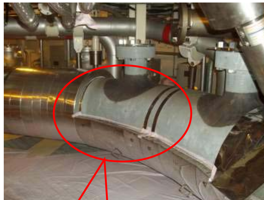
主蒸気系配管外観
