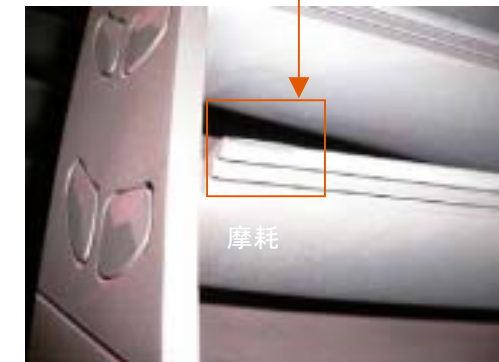
第13段発電機側 湿分分離翼部
