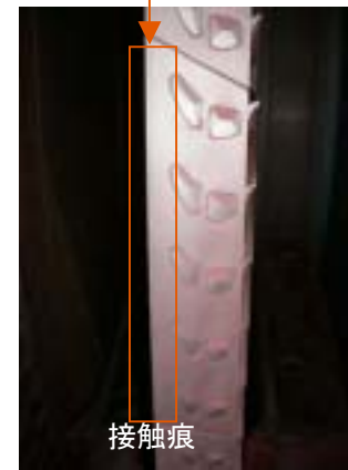
第13段発電機側 シュラウド部
