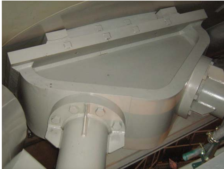
図⑧-1 PCV スタビライザ写真 (新潟県中越沖地震後 (耐震強化工事前) の状態)
