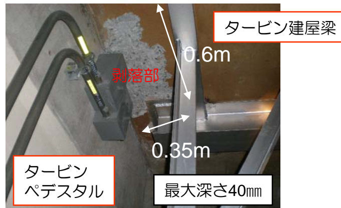
剥落部位写真
