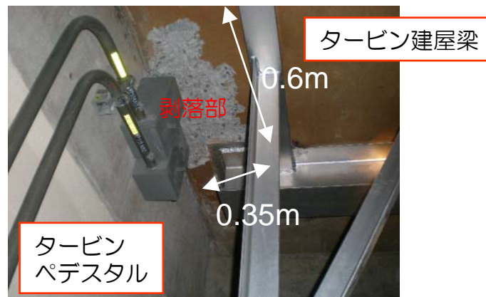
剥落部位写真
