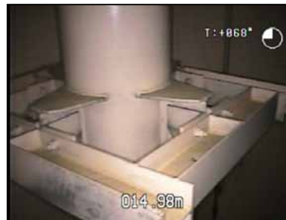
配管支持架台
