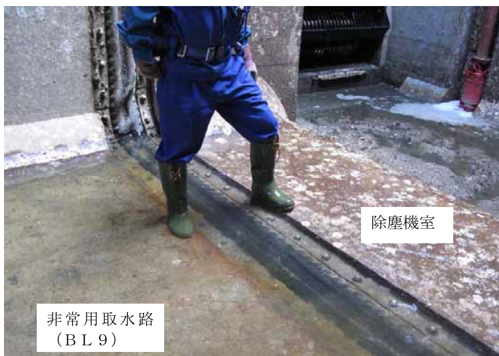
参写真-1.4 除塵機室との接合部における段差
