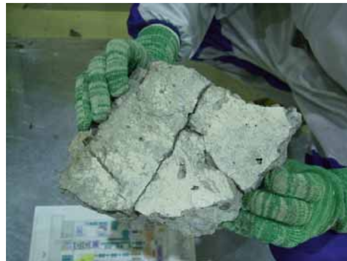
落下したコンクリート片
