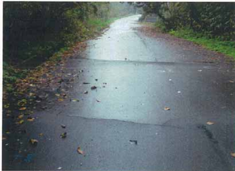
路面亀裂・段差・波打ち (測量箇所 延長1000m付近) 海側から内陸側を撮影。測線は写真左側。
