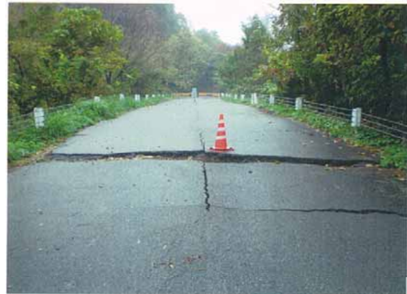
路面亀裂・段差・波打ち (測量箇所 延長1260m付近) 海側から内陸側を撮影。測線は写真左側。
