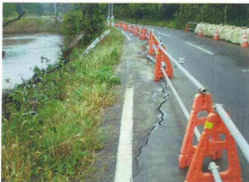
損傷箇所: 路肩崩壊: 修復中 (測量箇所 延長1800m付近) 海側から内陸側を撮影。測線は写真左側。
