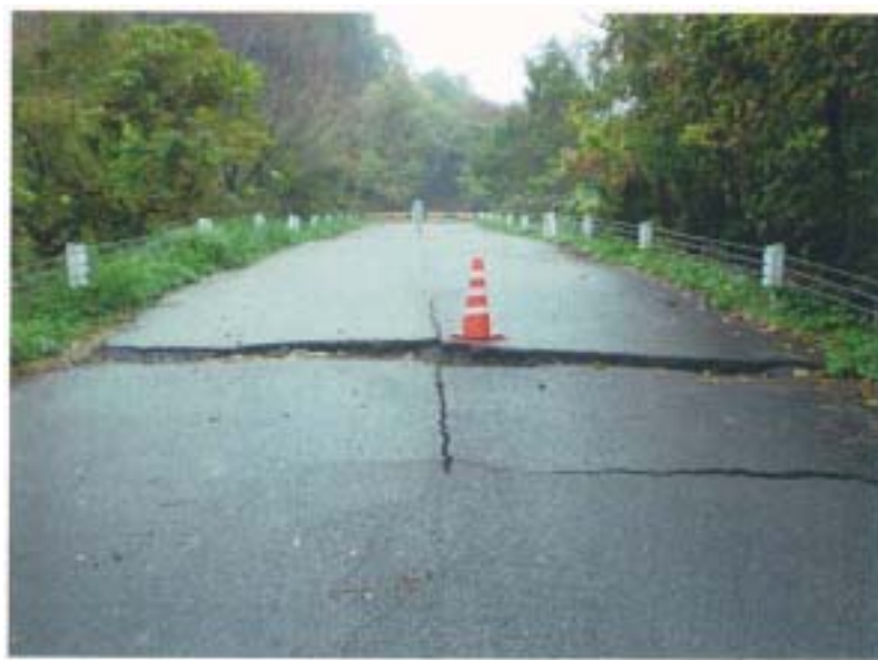
地震直後の被災状況（亀裂・段差大）
