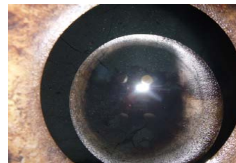
吸着塔 8 A 吸着材 3 (黒色) の上に若干 の白い堆積物を確認
