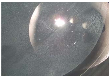
吸着塔 2 A 吸着材 4 (黒色) の上に白 い堆積物を確認
