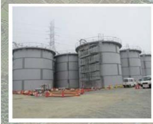
タンクの設置状況
