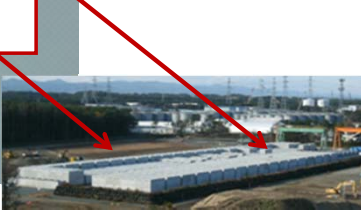
使用済吸着塔一時保管施設
