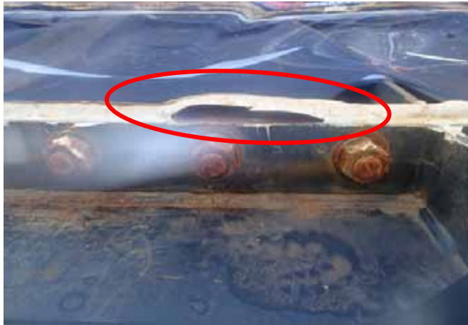
底板フランジ部シーリング材の膨らみ (平成25年9月19日撮影)
