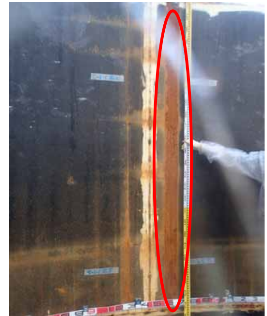
側板1段目 錆の箇所 (平成25年9月19日撮影)
