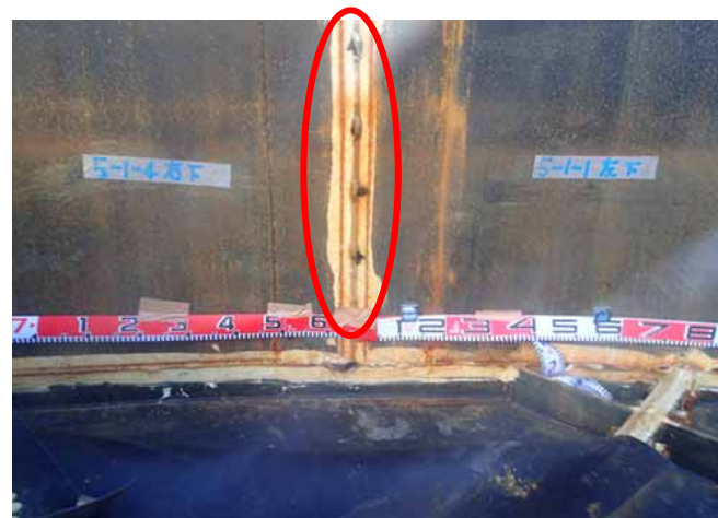
側板1段目縦フランジ部 パッキン飛び出し (平成25年9月19日撮影)
