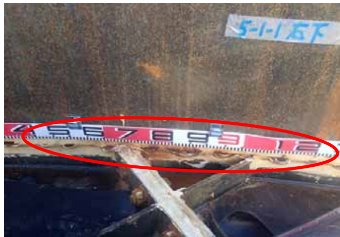
周方向フランジ部 パッキンの飛び出し (平成25年9月19日撮影)
