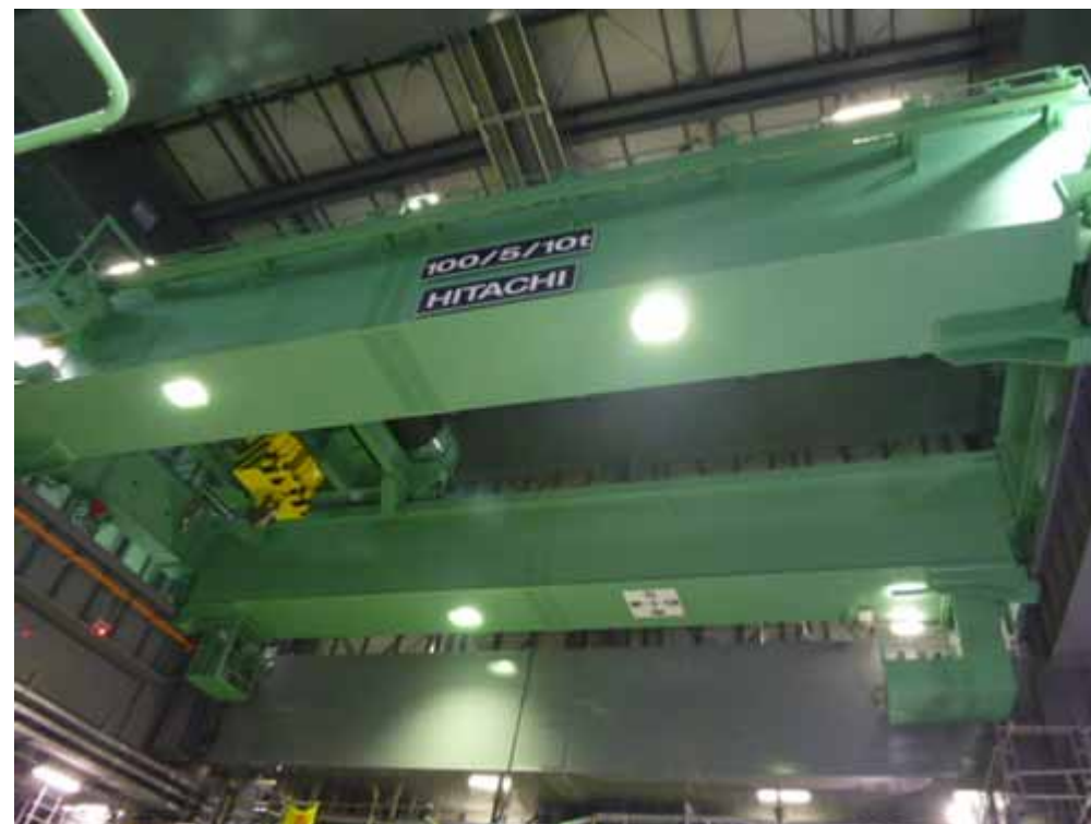
②天井クレーン全体（オペレーティングフロアより見上げたもの）
