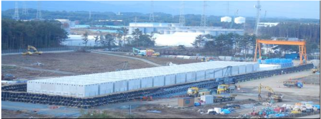
セシウム吸着塔一時保管施設全景
