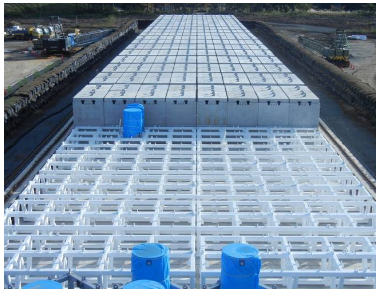
セシウム吸着塔一時保管施設設置状況 (シートで梱包されているセシウム吸着塔は未使用品)
