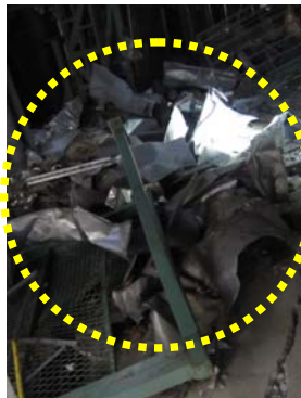
⑮空調ダクトの残骸
