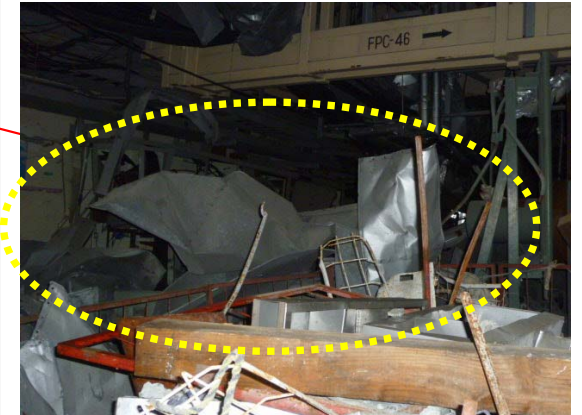
⑯空調ダクトの残骸
