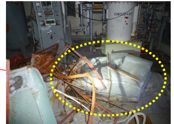
⑰空調ダクトの残骸
