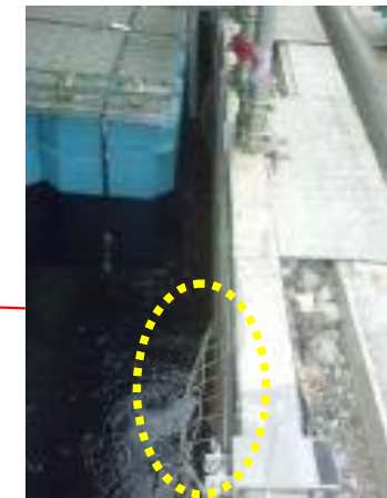
⑤使用済燃料プール空調ダクト吸気口の網が逆流方向へ張り出し
