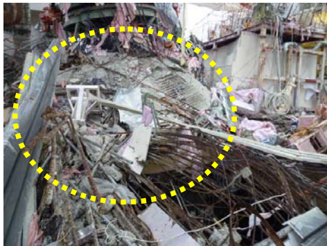
②床面の捲れ上がり
