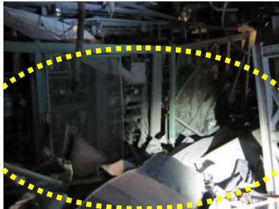
⑭床面の下方への変形 (手前は空調ダクトの残骸)
