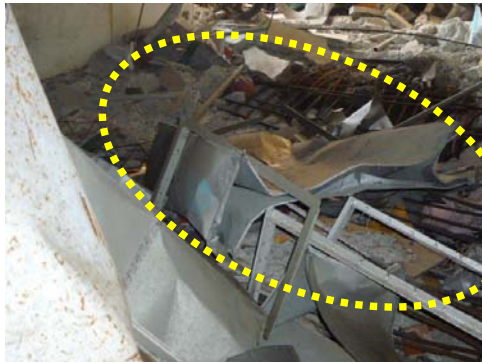
⑬床面の損傷
