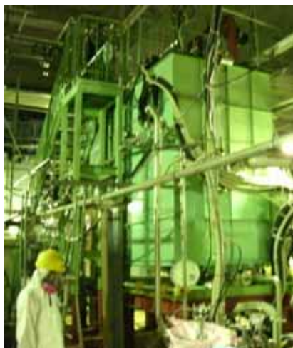
超高速凝集沈殿除染装置 (除染装置) 平成23年6月15日 当社社員撮影
