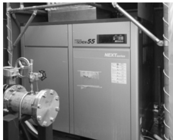
除染装置 コンプレッサー外観
