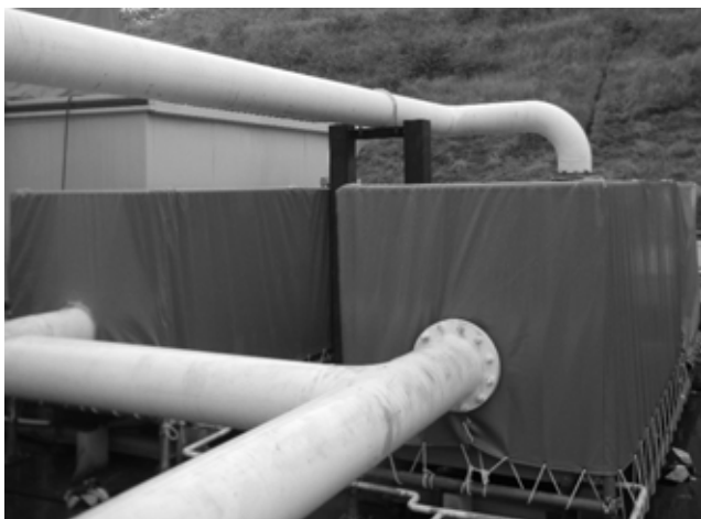
除染装置 排気装置外観
