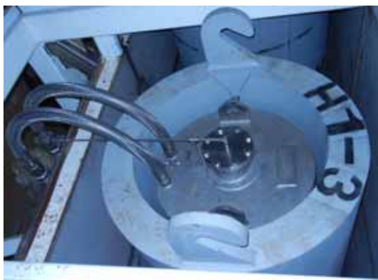
Hスキッド (セシウム吸着塔) 平成23年6月6日 当社社員撮影
