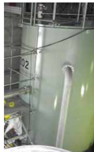
反応槽 (除染装置) 平成23年6月7日 当社社員撮影
