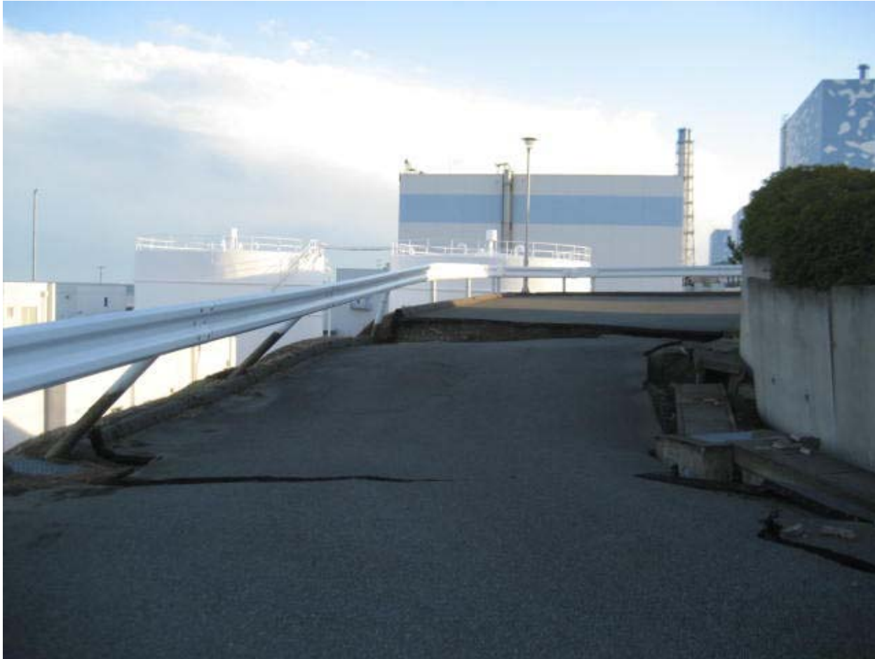
道路の陥没状況(4、11ページ)
