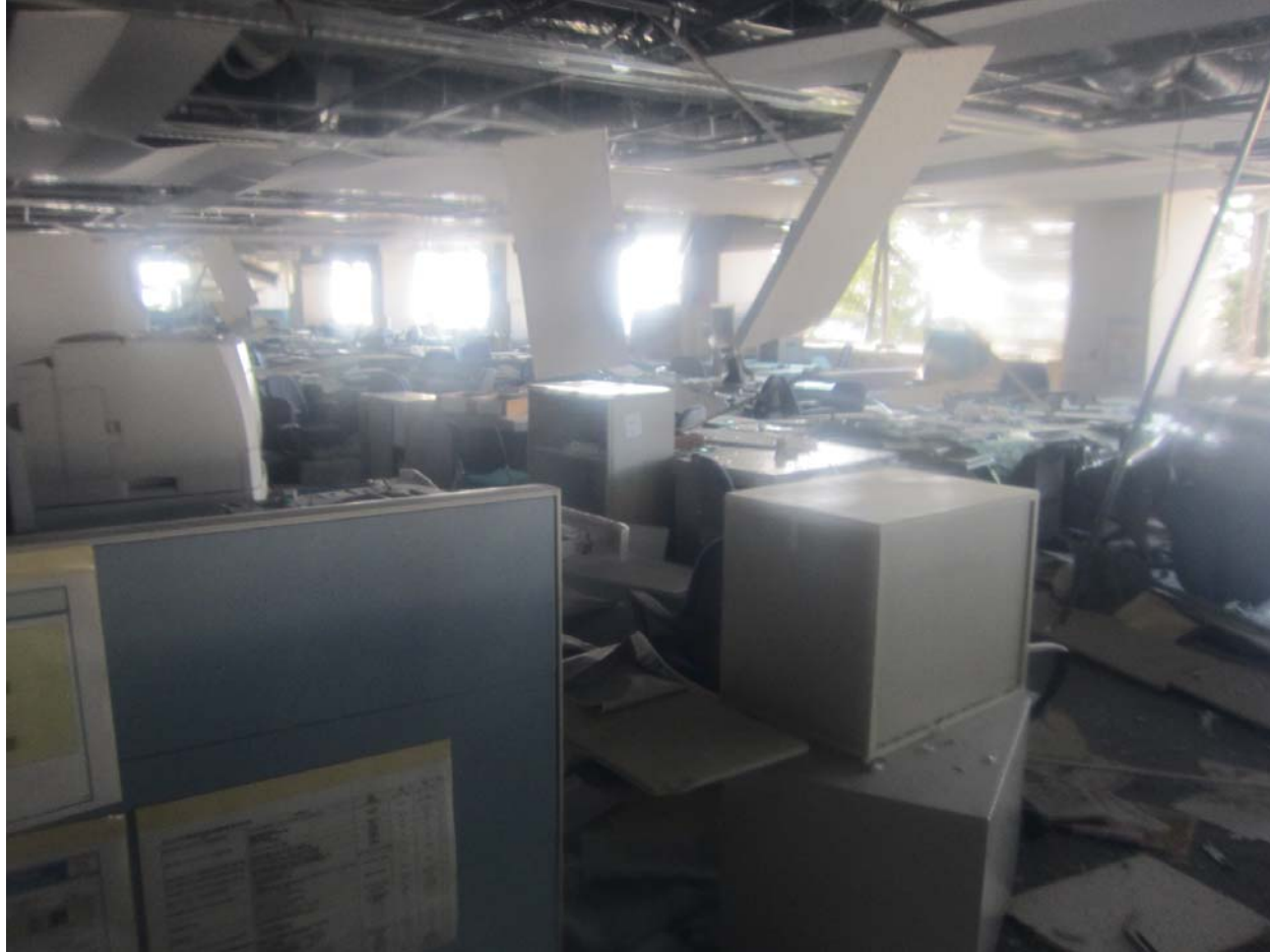
事務本館の被災状況(14ページ)
