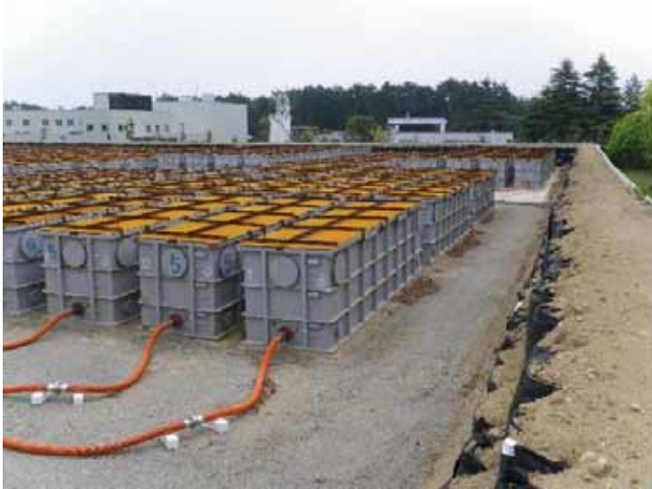
撮影:東京電力株式会社 撮影日:平成23年6月5日10:00頃 場所:敷地西側(正門付近) 角型タンク置場 目的:蒸発濃縮装置の受タンク
