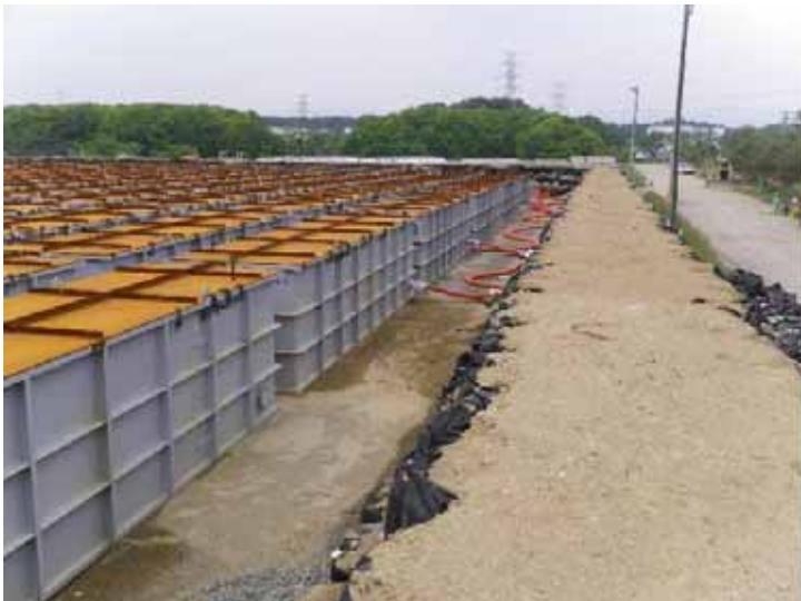
撮影:東京電力株式会社 撮影日:平成23年6月5日10:00頃 場所:敷地西側(正門付近) 角型タンク置場 目的:淡水受タンク
