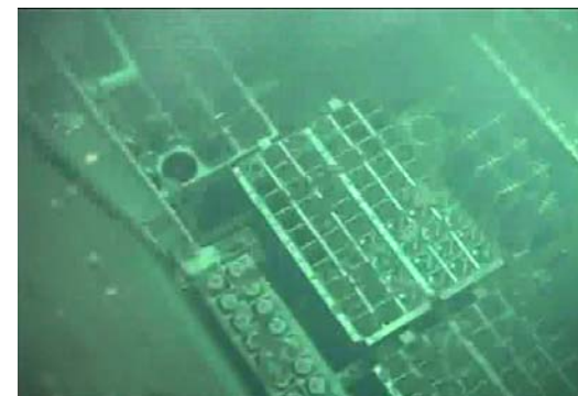
図3 使用済み燃料プール内部の状況(4月28日撮影)
