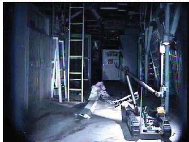
⑥ 北側水圧制御ユニット脇 線量 119.0mSv/h, 温度 28.8°C
