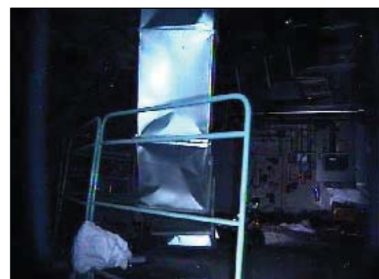
⑧ 水圧制御ユニット～西側エアロック 線量 63.7mSv/h, 温度 28.5°C 湿度 38.3%, 酸素濃度 20.9%
