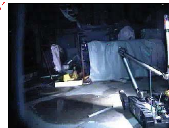
③ 原子炉建屋二重扉(北側)付近 線量 48.6mSv/h, 温度 30.4°C 湿度 43.6%, 酸素濃度 20.9%
