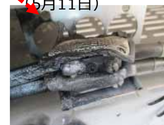
ブレーキレジスタ内の損傷 (5月12日)
