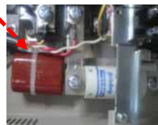
損傷の確認されたヒューズ (4月25日)
