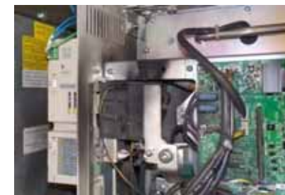
主巻インバータ内部の煤 (5月11日)
