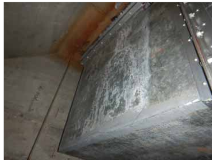
④中操内ダクト
