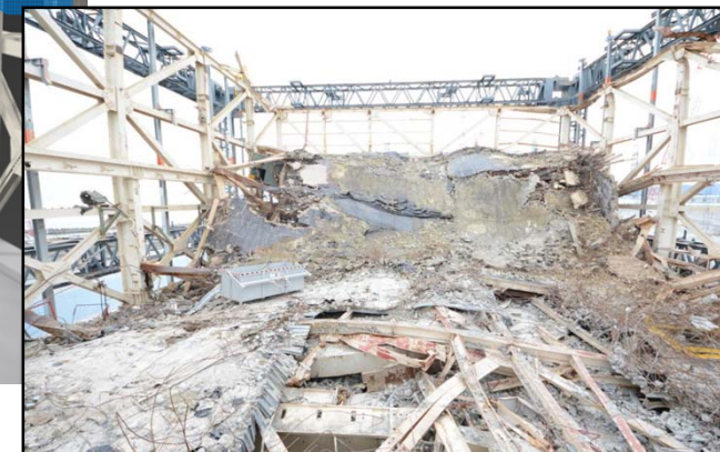
崩落屋根の状況
