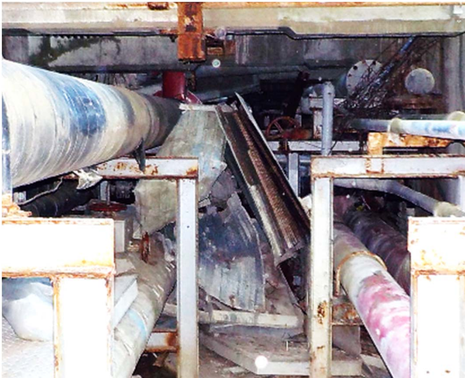
2号機共通配管トレンチ内部のガレキの状況（2018年2月）
