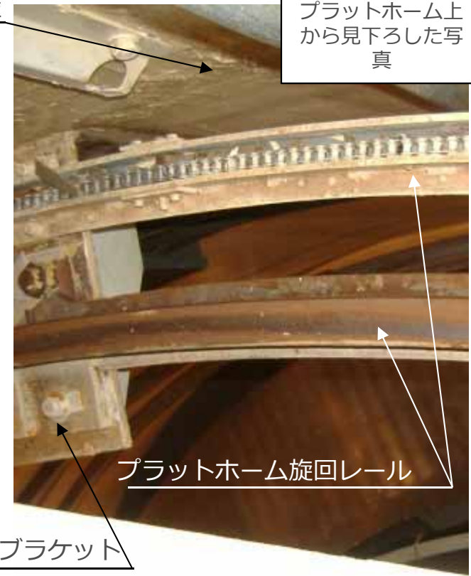
震災前のプラットフォーム回転レール (3号機)
