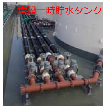
増設一時貯水タンク 排水・攪拌ライン
