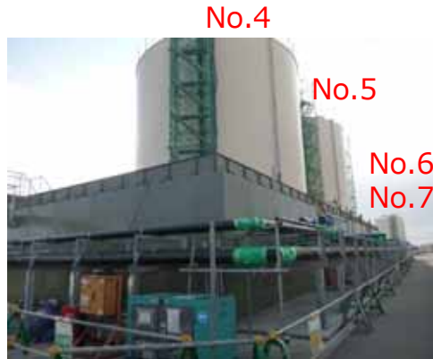
増設集水タンク
