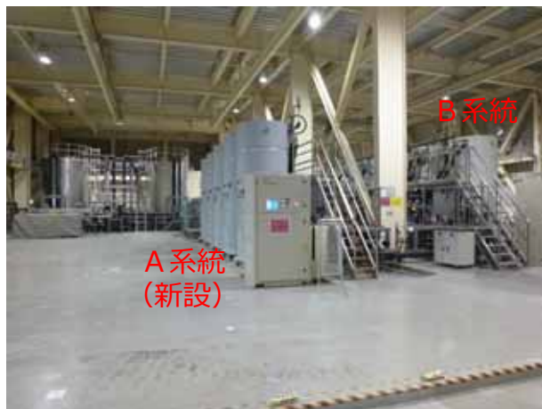
サブドレン浄化装置
