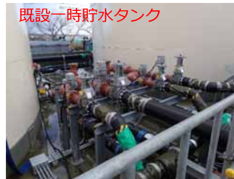
既設一時貯水タンク 二重化ライン
