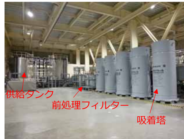
サブドレン浄化装置 (新設)
