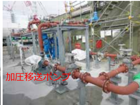
加圧移送ポンプ周り
