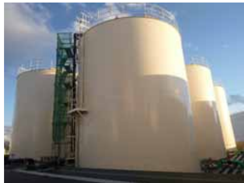
増設一時貯水タンク
