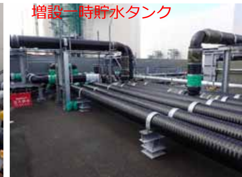
増設一時貯水タンク 排水・攪拌・受入ライン
