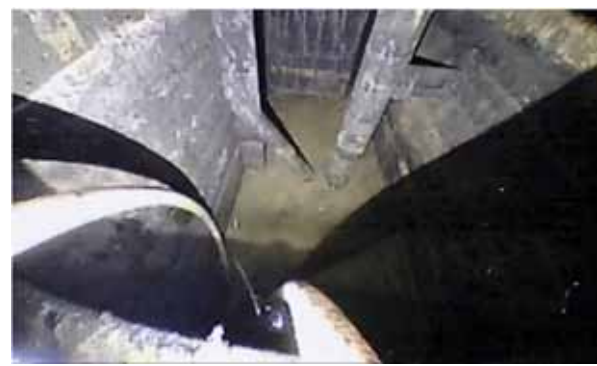
3号機復水器水抜後の状況（H/W天板から復水器底板を撮影）
