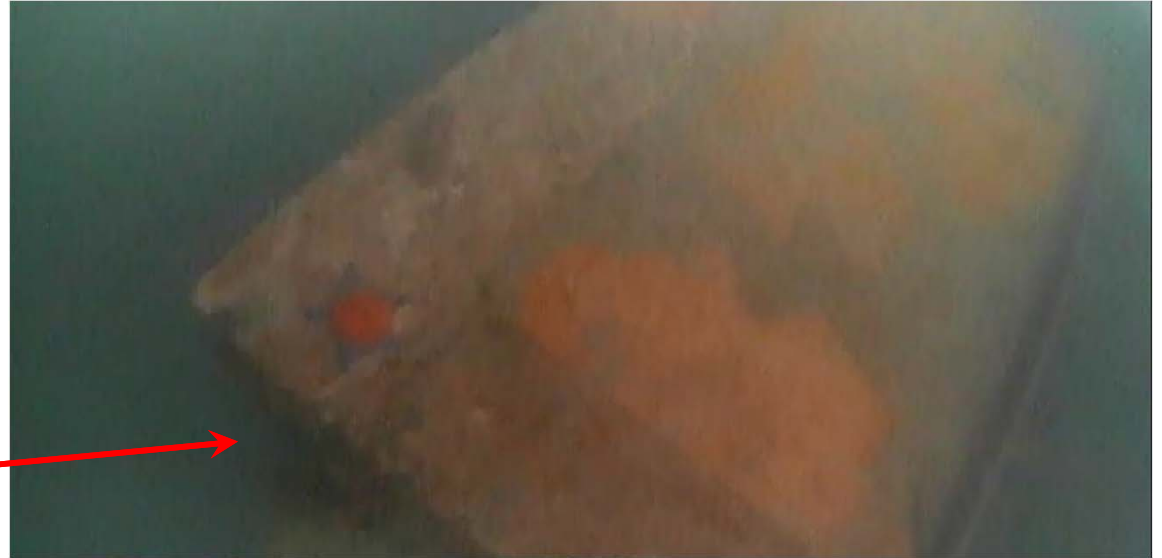
海中のブロックフェンス(底面部が水面方向を向いている)
