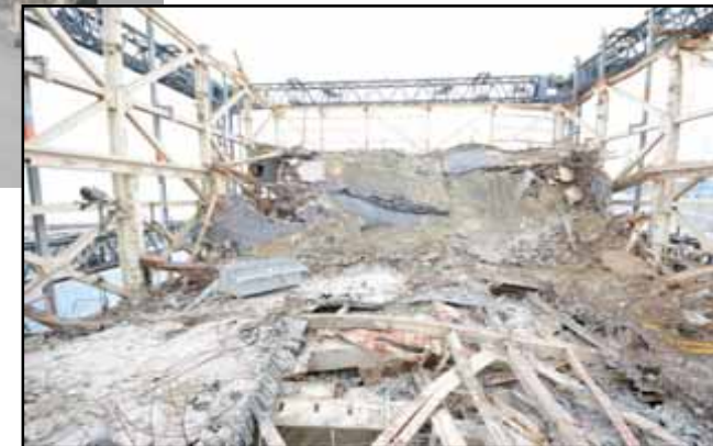
崩落屋根状況
