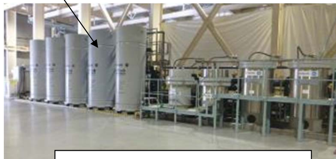
サブドレン他浄化設備
