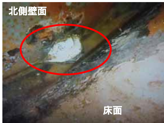
【部】(矢視D) 突起物と約5cmの割れ
