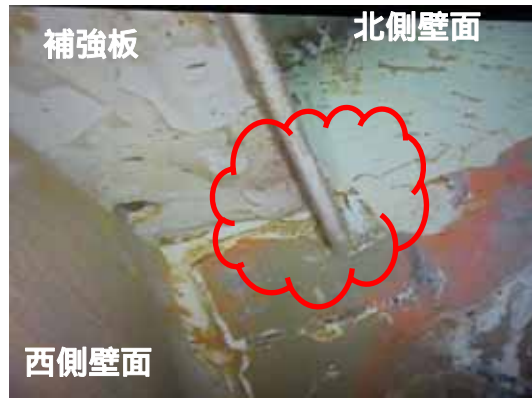
【部】(矢視A) 約4cmの割れ
