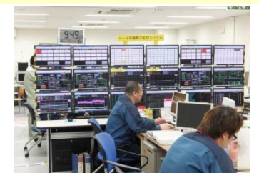
集中監視システム設置完了
