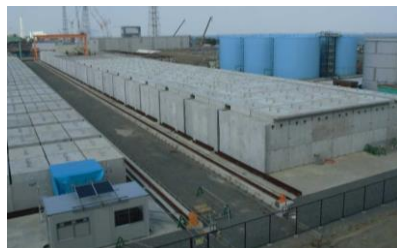
使用済み吸着塔類のコンクリート製の一時保管施設への収納
