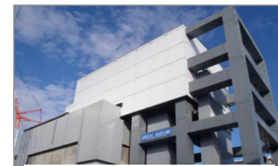
⑦-2 4号燃料取り出し用カバー
