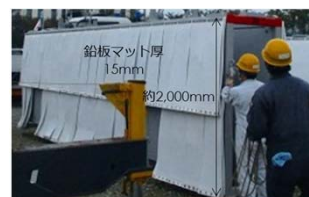
衝立形状の仮設遮蔽体①
