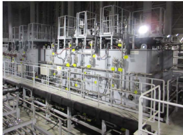
増設多核種除去設備 吸着塔
