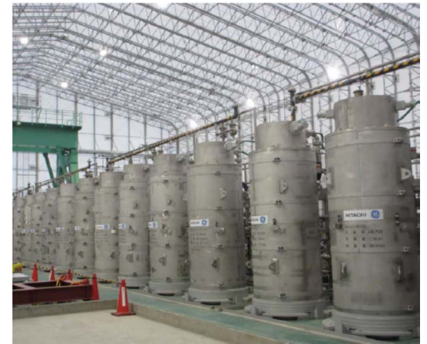
高性能多核種除去設備 吸着塔
