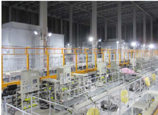
増設多核種除去設備 HIC取扱エリア
