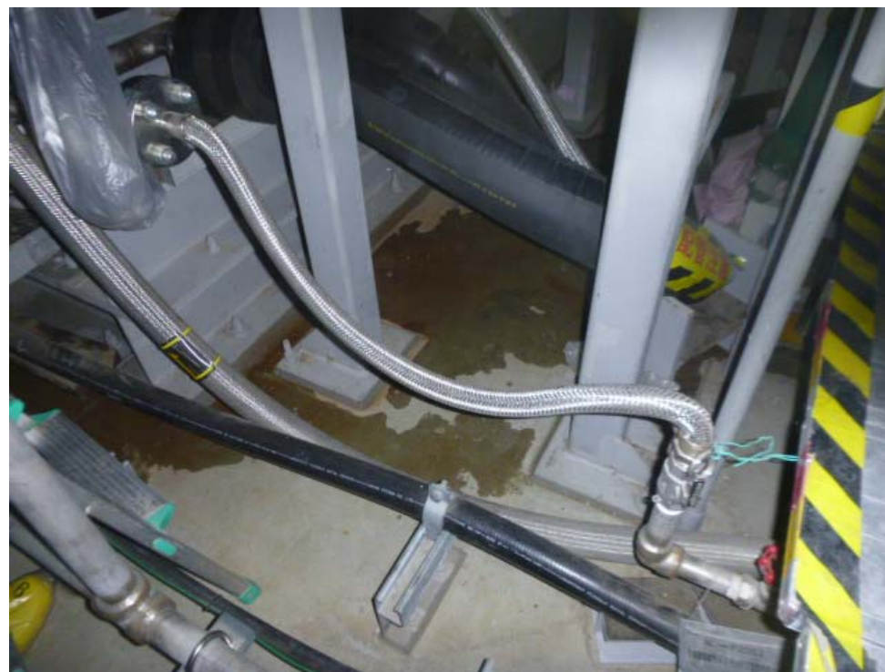
漏えいした床面の状況
