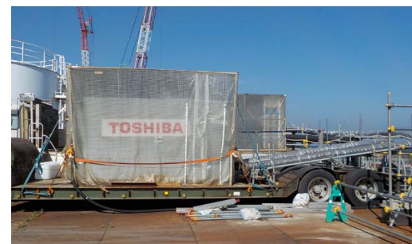
放水路浄化装置（吸着塔ユニット）
