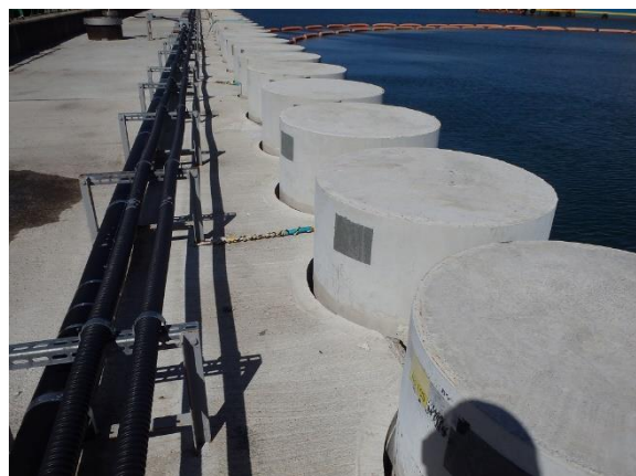
鋼管矢板際の状況（補修実施前） （右写真の補修実施後の場所とは異なる）
