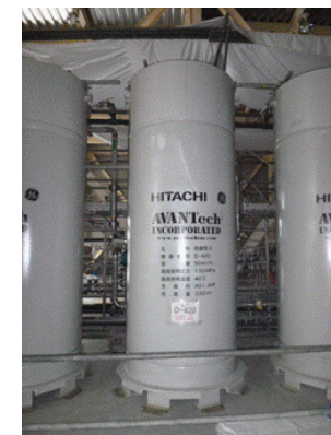
サブドレン等浄化 (吸着塔)
