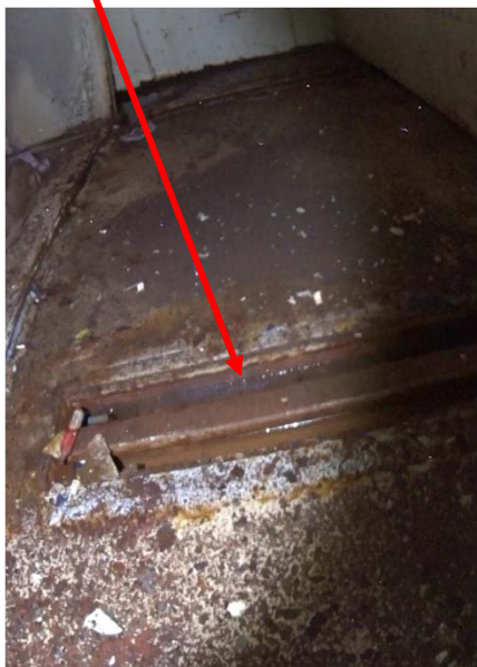
レール溝に水溜りあり
