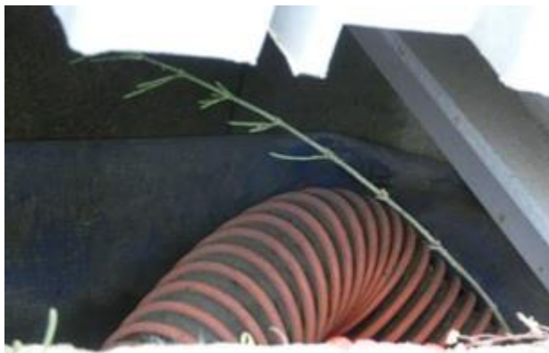
※漏えい発見時のホース状態(屈曲あり)
