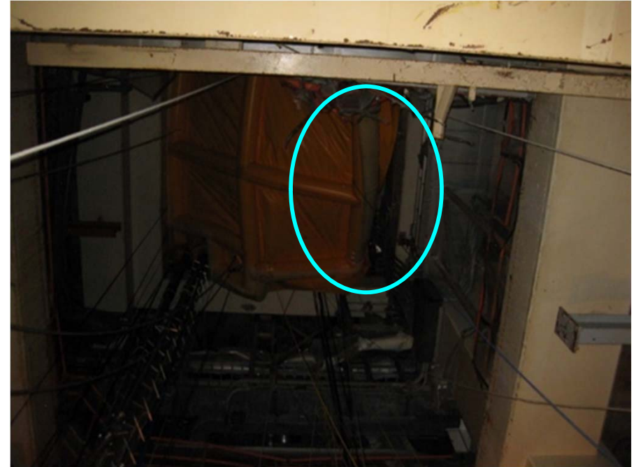
現在のずれている状況 (2015年5月21日撮影)
