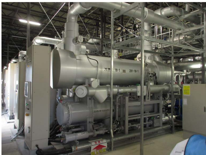
冷凍機設置状況
