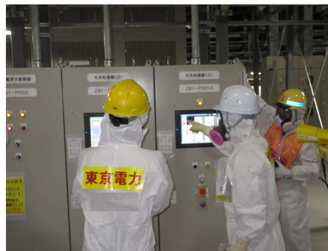
起動操作前最終確認の状況
