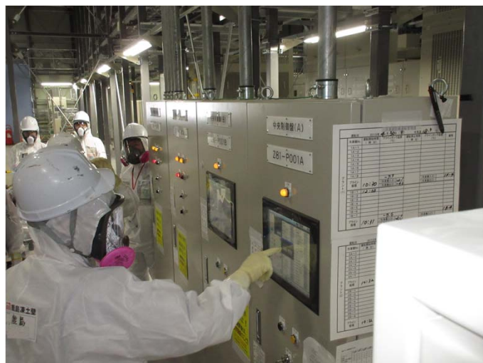
冷凍機起動操作の状況
