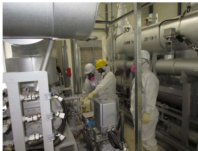
起動操作後の設備確認状況
