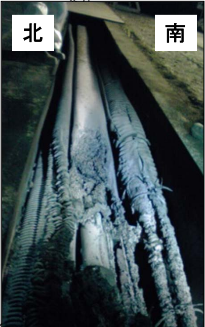
ケーブル・ホース類の損傷状況
