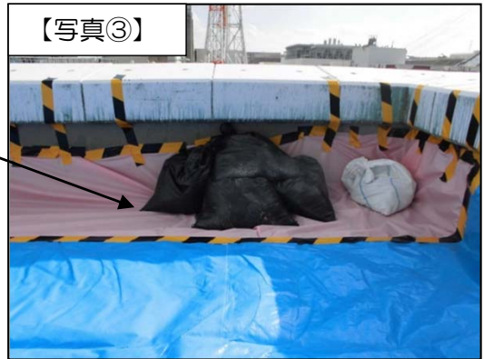
ブルーシート掛け実施状況
