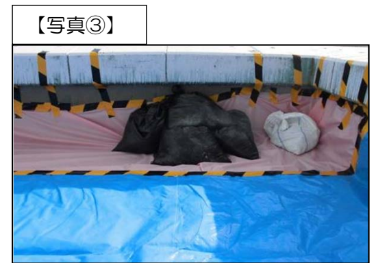
ブルーシート掛け実施状況
