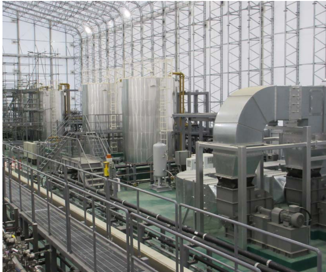
処理水タンク・供給タンクエリア
