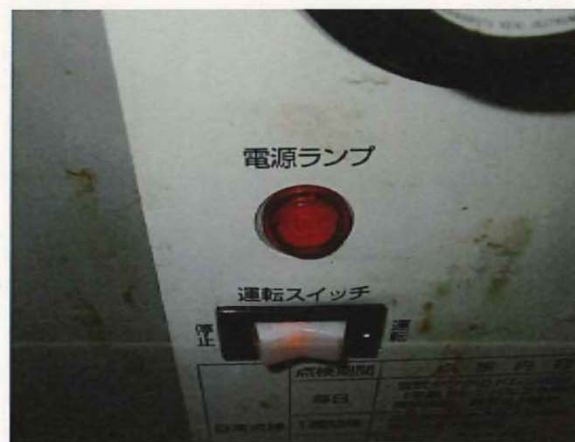
運転スイッチ中間位置(ランプ点灯)
