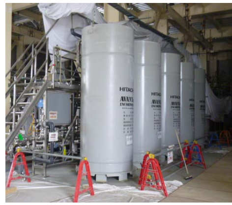
浄化設備 (吸着塔)
